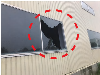
窓ガラスの破損
