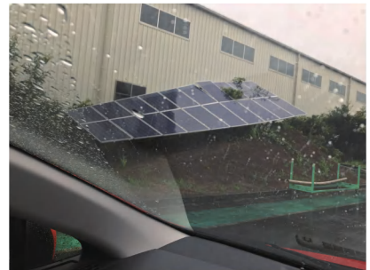
太陽光架台からパネルの外れ
