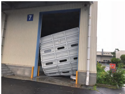
シャッター破損
